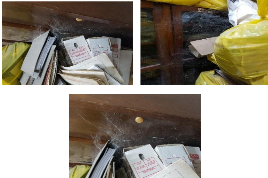
Figura 5 - Imágenes del estado de mantenimiento en que se encontraban los EC.
